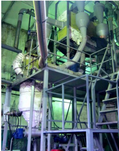
Общий вид установки
