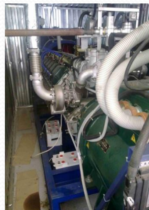
Газоэлектропоршневая установка АП-315
